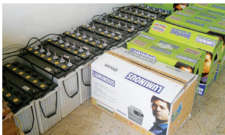
De zonnepanelen zouden niet nuttig zijn zonder de UPS (Uninterruptible Power Supply) en de bijhorende batterijen.
